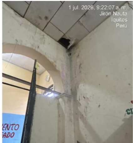
Deterioro por humedad
